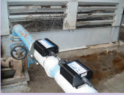
Soğutma kulesini koruyan Frekans Jeneratörü
